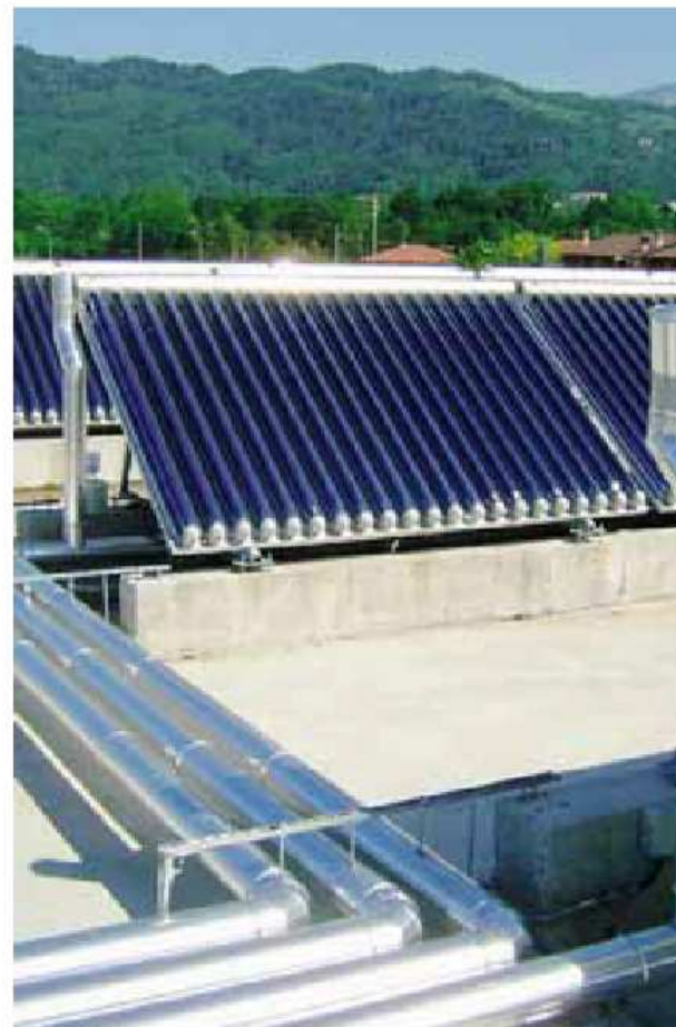
Un particolare del progetto pilota di «solar cooling» a Sotto il Monte
